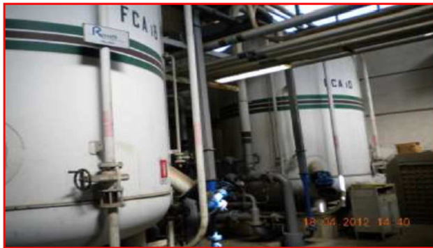
Figura 19 Impianto di depurazione
