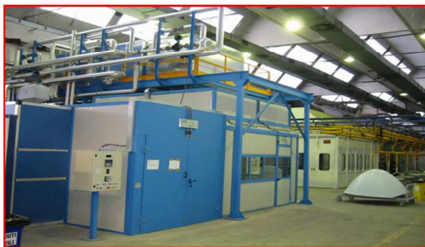
Figura 11 Impianto di verniciatura in box
